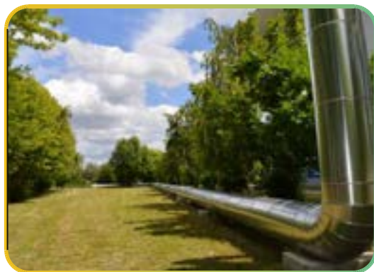
Réseau de vapeur au départ d'ECOSTU'AIR (thermique)
